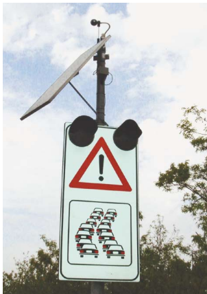
TrafiCam Collect-R installato su una struttura preesistente
