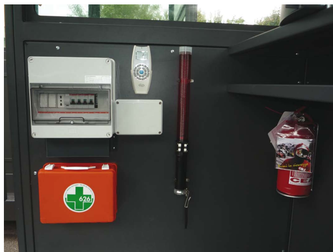
Quadro elettrico, cassetta pronto soccorso, bastone luminoso multifunzione, estintore
