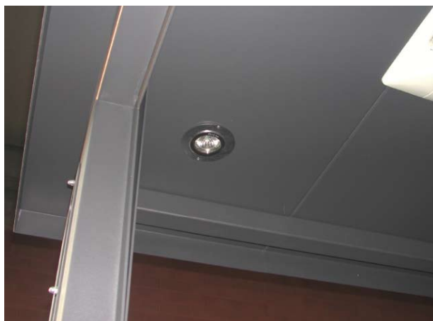
Faretti di illuminazione interna a soffitto
