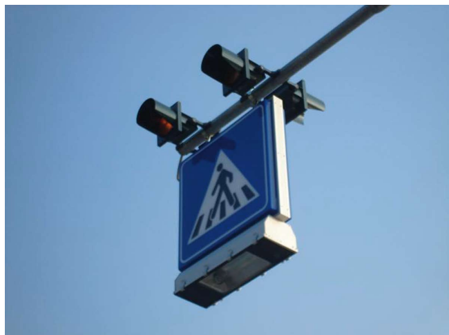
Particolare plafoniera di illuminazione
